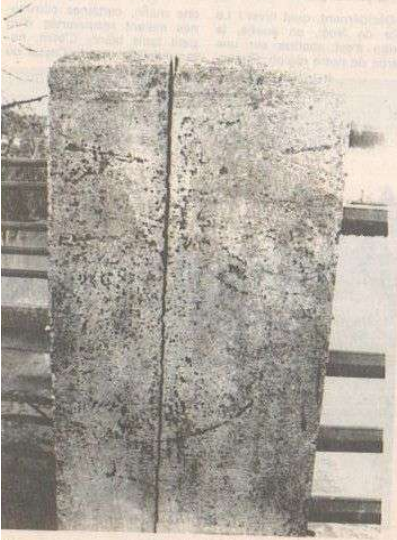
Fissure au pont Saint-Pierre.
